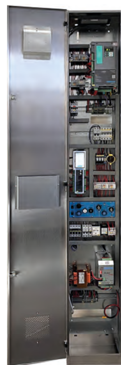
Quadro di controllo Control panel
